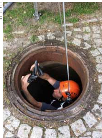
Stefan Lindgren, teknikchef på Talkpool, installerar dagvatten-sensorer i en av Göteborgs avloppsbrunnar.
